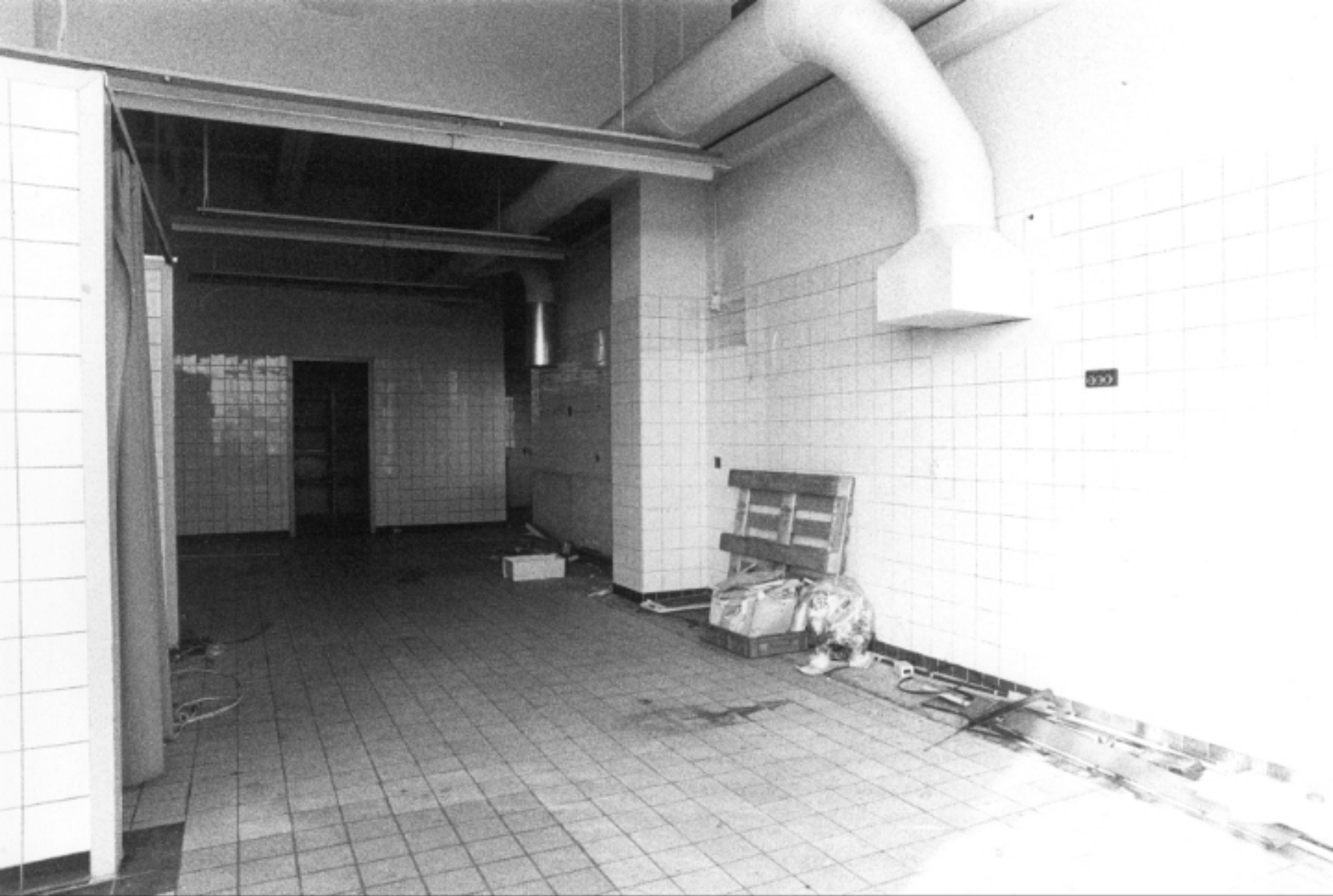
Interieur van een leegstaande bedrijfskeuken in gebouwdeel EF van De Witte Dame (zijde Emmasingel).
